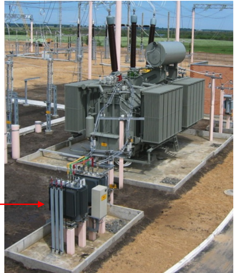
MCR 180 Mvar 330 kV para BELENERGO SS «Baranovichi» (Bielorrússia)
